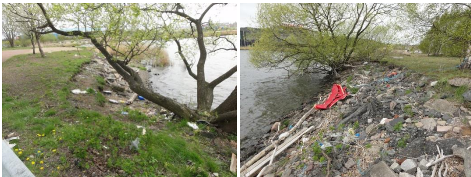
Figur 6. Strandzonen utmed Kvillepiren är bitvis bevuxen av buskar, träd, sly och gräs. Erosionsförhållanden i Lundbyhamnens inre hamnbassäng (till vänster) och utmed Kvillepirens norra strandkant (till höger) är bitvis otillfredställande.
